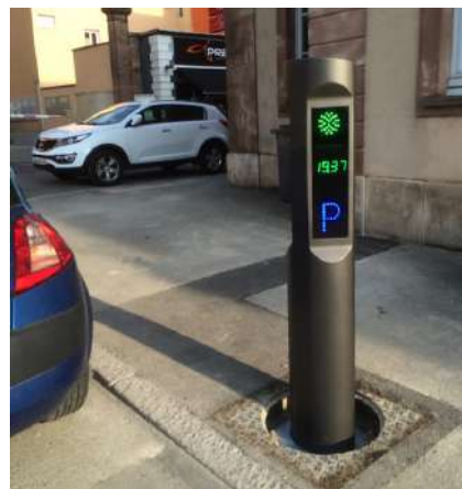
Borne de contrôle du stationnement permettant une rotation des véhicules optimale : jusqu'à 50 véhicules/jour.
